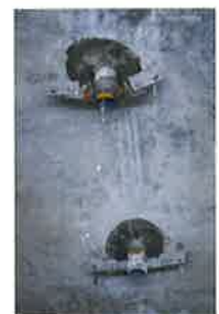
水が滴る集水ボーリング先端。
