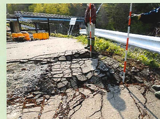
発電施設の変状
